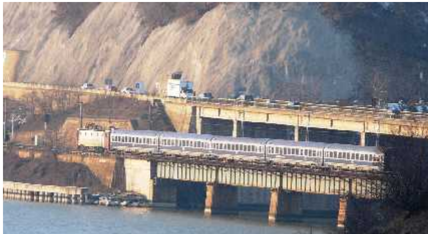
Calea ferată în sectorul de defileu (zona Gura Văii – Erghevița), probleme cu stabilitatea versanților (foto: MT)
