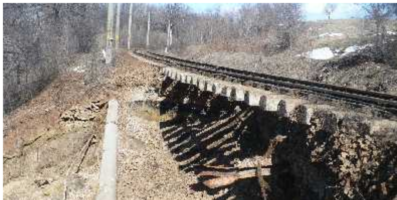
Alunecare de teren care a afectat coridorul TEN-T Core în zona Balota (foto: MT)
